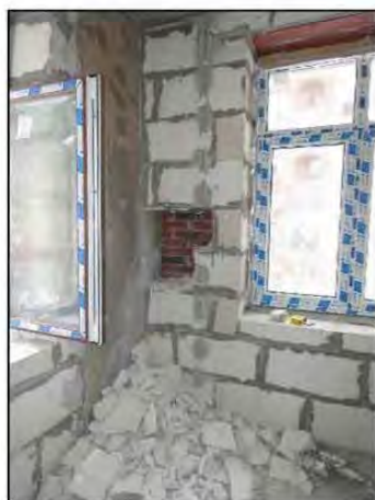
ФОТО 23. Общий вид вскрытия ограждающих конструкций третьего этажа жилого дома по осям T/2 / 29/2.
