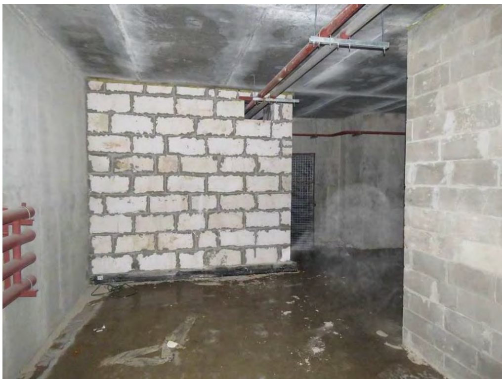
Рис. 3.1.11. Замачивание верхней поверхности фундаментной плиты с последующим замерзанием и фазового перехода воды в лед на высоту до 50 мм
