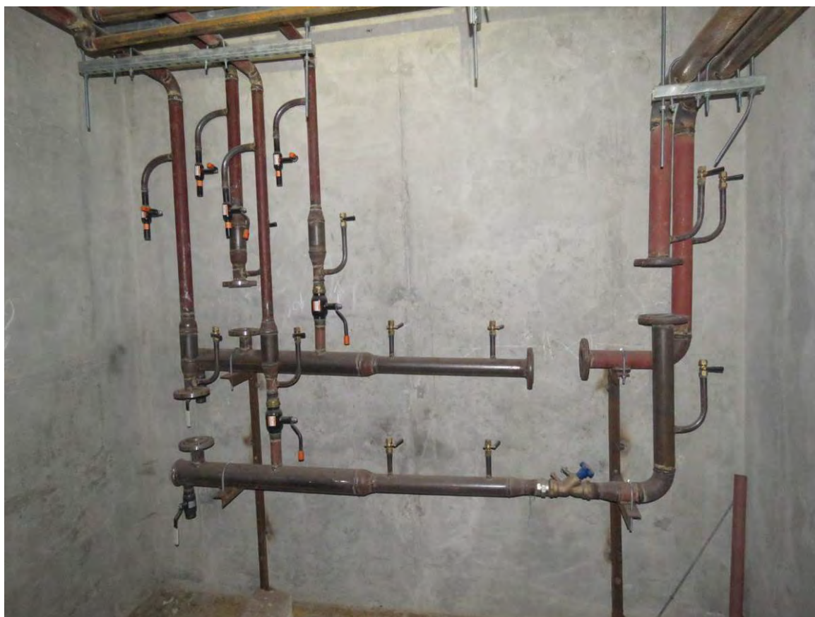
Рис.3.7.1.4. Общий вид смонтированного оборудования узлов управления системой теплоснабжения
