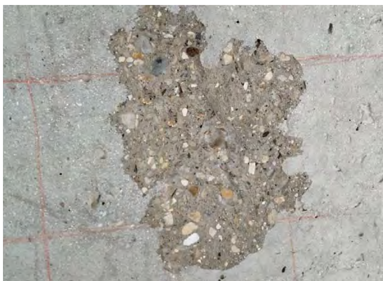
Рис. 4.2.7. Внутренняя область бетона после проведения испытаний
