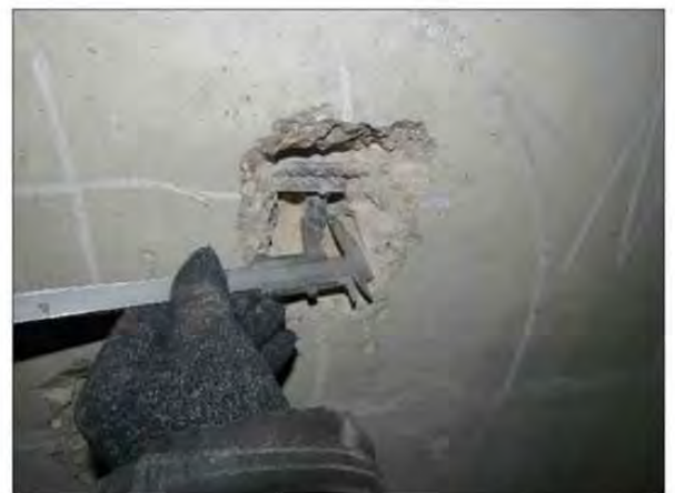
ФОТО 12. Уточнение диаметра рабочей арматуры монолитного железобетонного пилона подвала жилого дома по оси Н/2 и между осями 27/2-28/2 .
