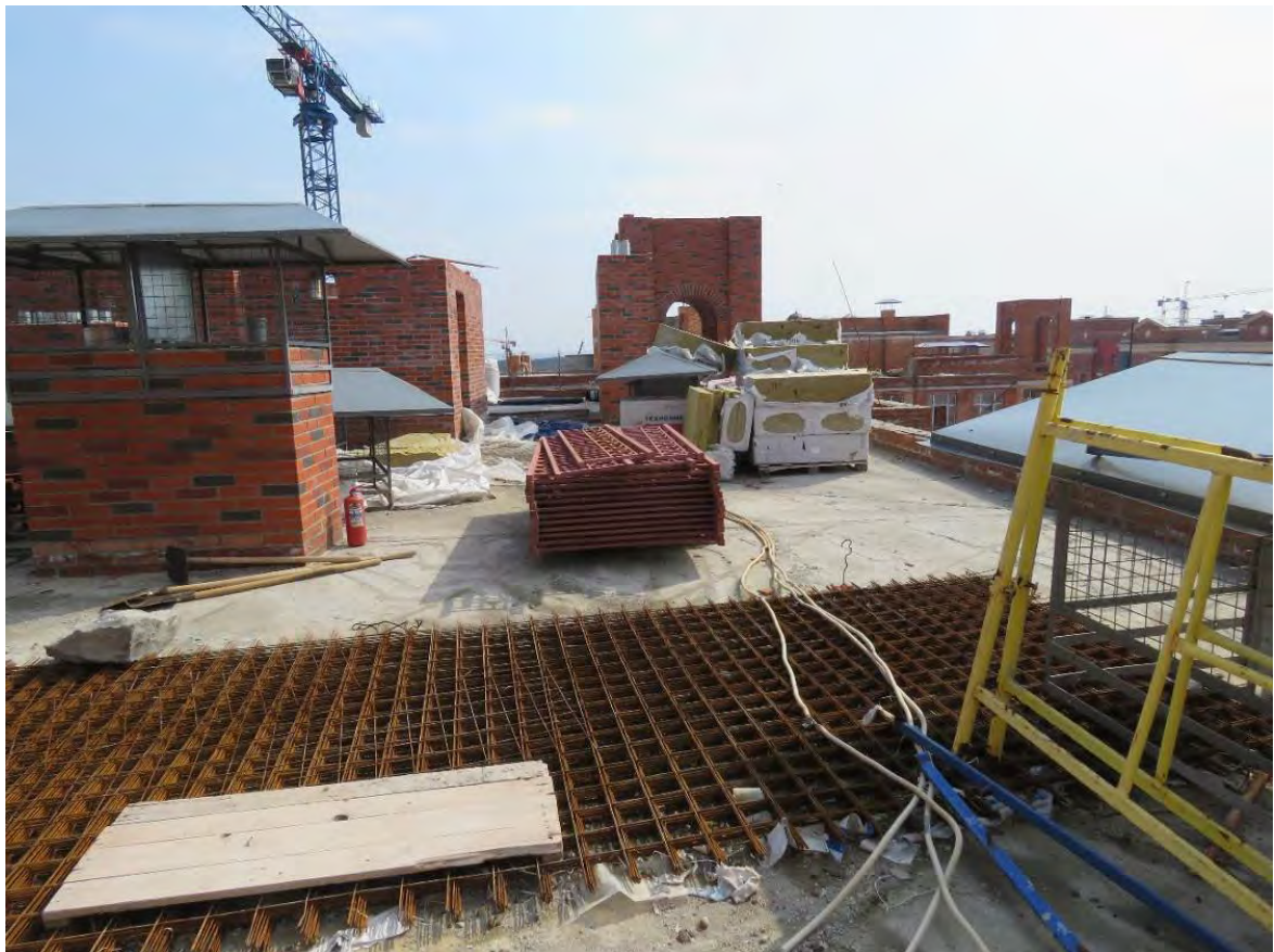
Рис. 3.6.10. Наличие мусора и складирование строительных материалов на кровле здания
