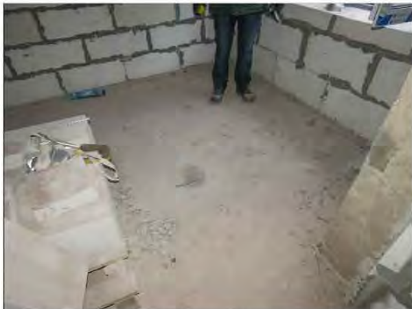
ФОТО 21. Общий вид вскрытия верхней зоны монолитной железобетонной плиты пола третьего этажа жилого дома между осями P/2-C/2 / 27/2-28/2 .
