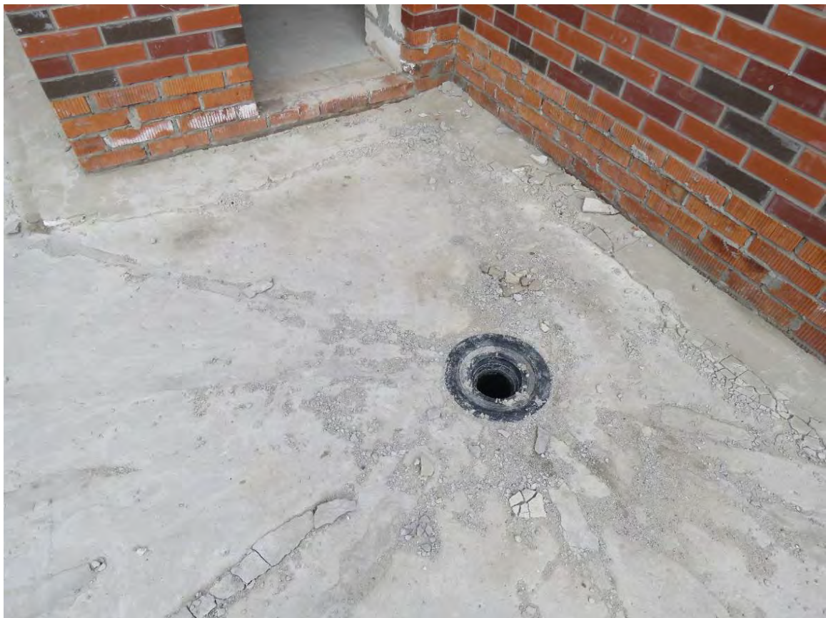
Рис. 3.6.8. Разрушение стяжки из цементно-песчаного раствора в зонах кровельных воронок
