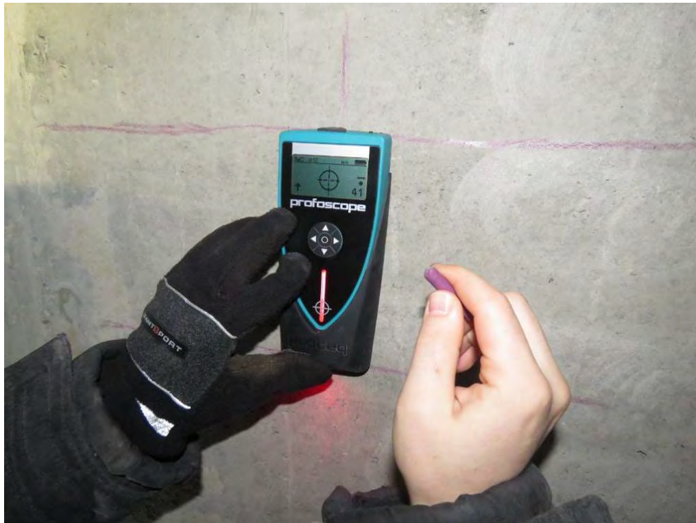
Рис. 3.2.7. Замер толщины защитного слоя бетона монолитной ж.б. стены на отм. -3,300 м при помощи прибора «Profoscope»
