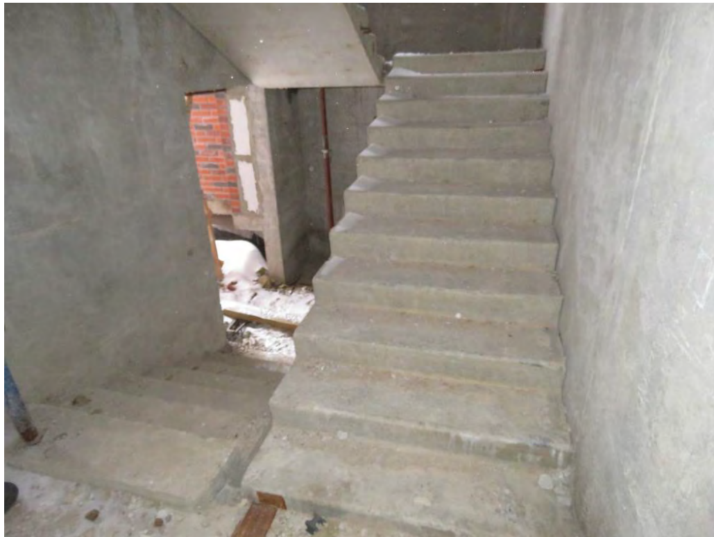
Рис. 3.5.1. Общий вид лестничной клетки расположенной в зоне 4-й секции (двухмаршевая лестничная конструкция с промежуточными площадками)
