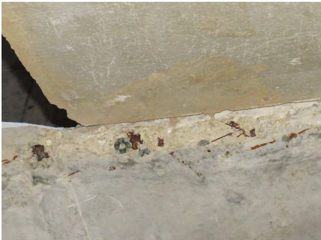
Рис. 3.5.8. Дефекты в виде крупных пор и раковин на отдельных участках монолитных площадок, с оголением и коррозией арматурного каркаса (поверхности арматурных стержней) на отдельных участках на длину 10÷20 мм.
