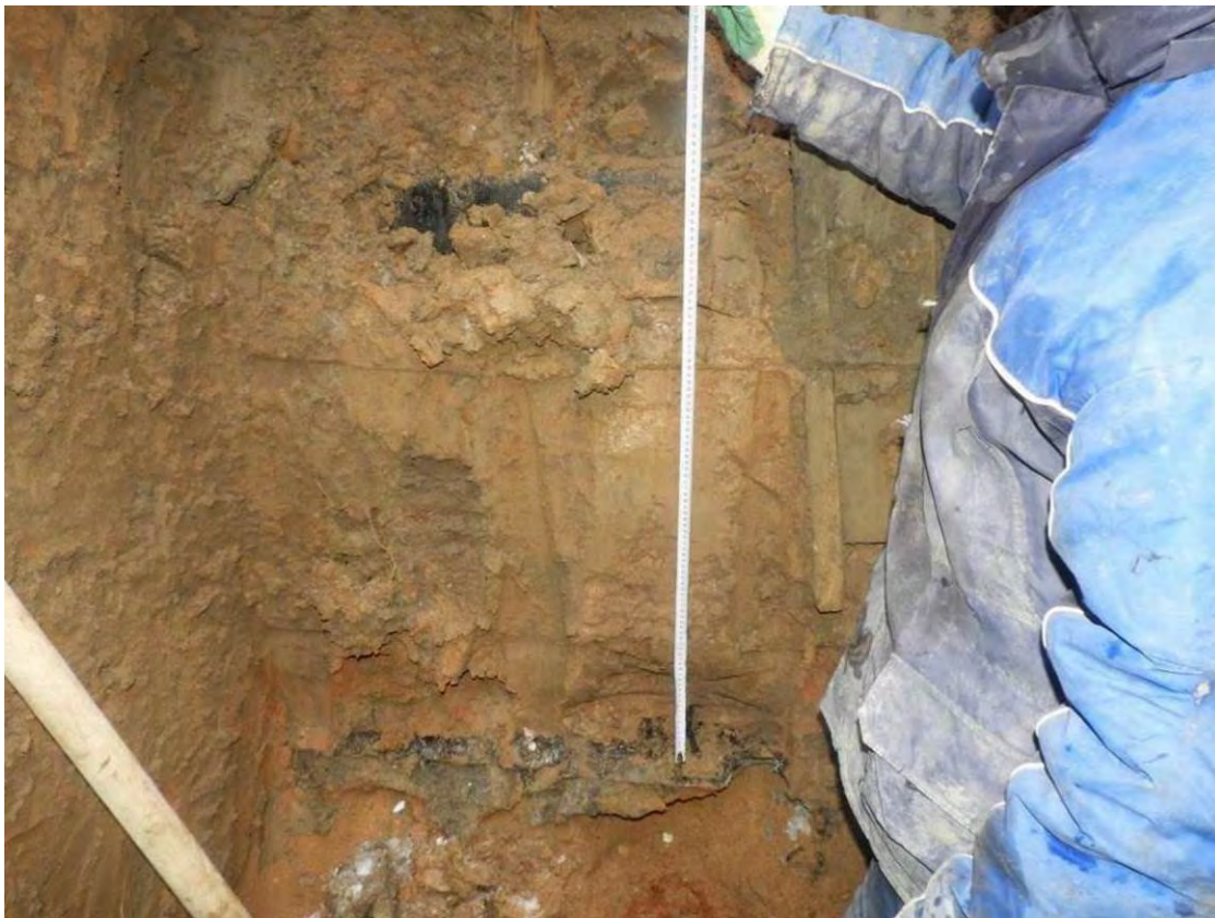
Рис. 3.1.3. Замер толщины фундаментной плиты в отрытом шурфе №1 секции 1 на пересечении осей Б/2 и 1/2
