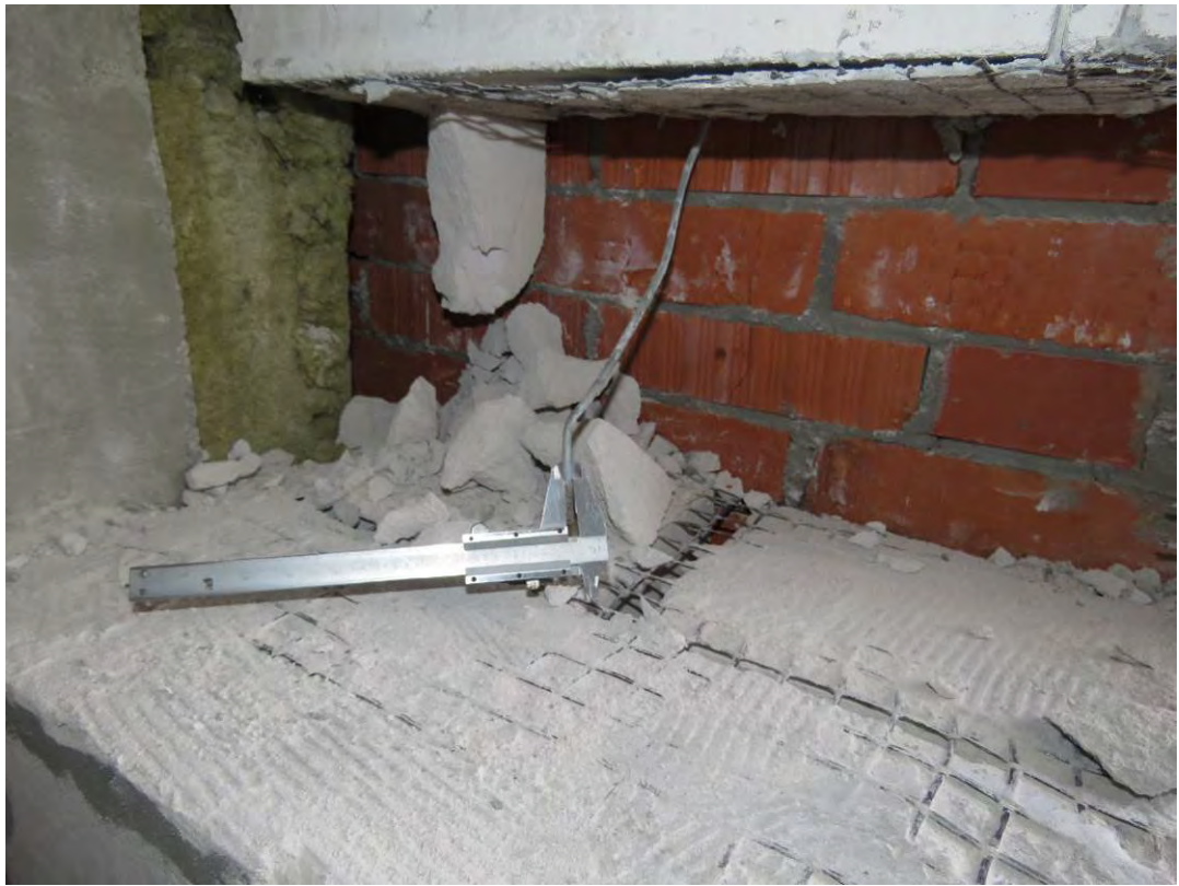
Рис. 3.4.9. Замер диаметра гибких связей в ограждающей конструкции наружных стен примыкающих к пилону в уровне 7-го этажа на пересечении осей А/2, 17/2
