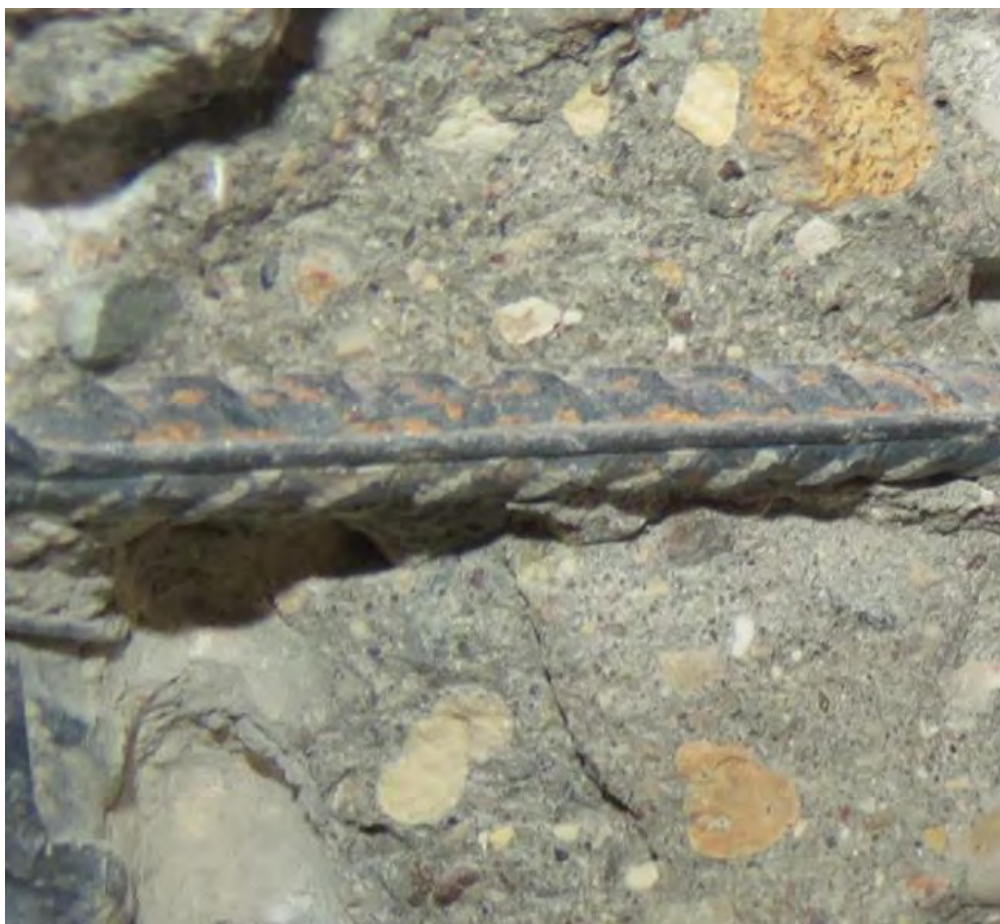
Рис. 3.2.8. Поражение арматурных стержней поверхностной коррозией монолитной ж.б. колонны
