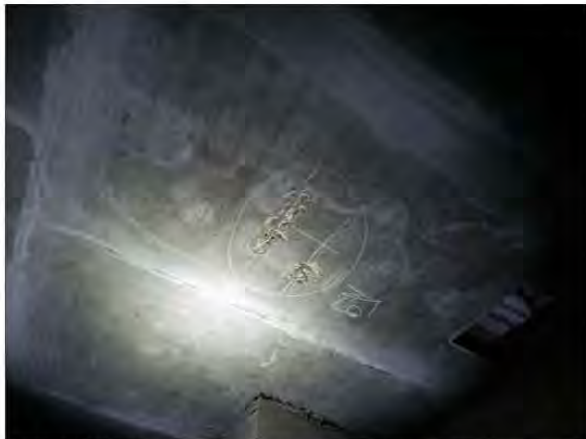
ФОТО 13. Общий вид вскрытия нижней зоны монолитной железобетонной плиты перекрытия подвала жилого дома между осями Р/2-С/2 / 27/2-28/1.
