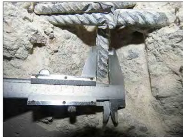
ФОТО 38. Уточнение диаметра рабочей арматуры монолитной железобетонной стены седьмого этажа жилого дома между осями Д/2-И/2 и по оси 19/2.
