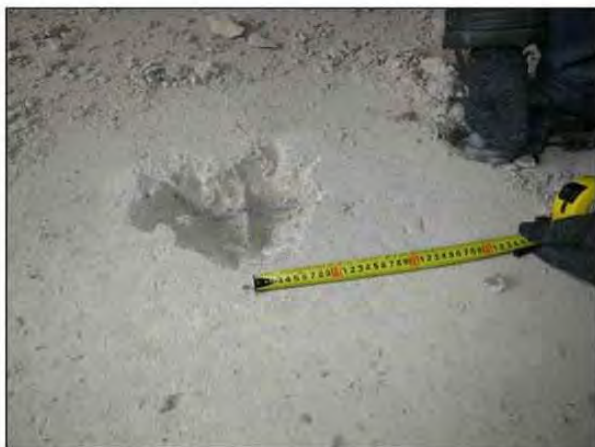
ФОТО 27. Общий вид вскрытия верхней зоны монолитной железобетонной плиты пола седьмого этажа жилого дома между осями 16/2-17/2 - Б/2-В/2.
