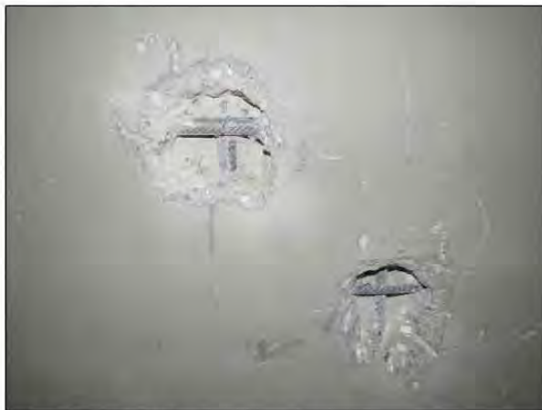
ФОТО 31. Общий вид вскрытия монолитного железобетонного пилона седьмого этажа жилого дома между осями А/2-Г/2 и 19/2-20/2.
