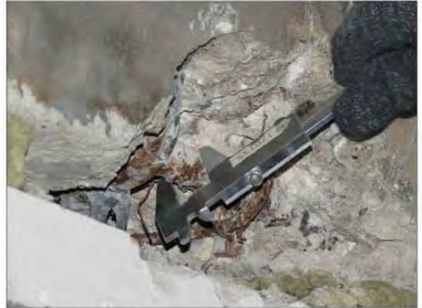
ФОТО 18. Уточнение диаметра рабочей арматуры монолитной железобетонной балки третьего этажа жилого дома по оси Н/2 и между осями 27/2 -28/2.
