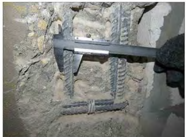
ФОТО 20. Уточнение диаметра рабочей арматуры монолитного железобетонного пилона третьего этажа жилого дома между осями 27/2-28/2 и по оси Н/2.
