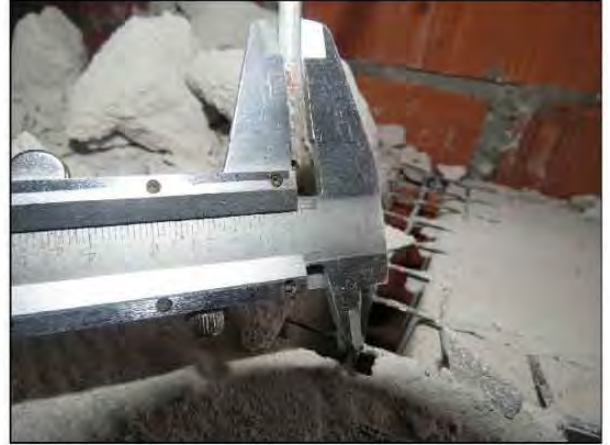
ФОТО 30. Уточнение диаметра гибких связей ограждающих конструкций седьмого этажа жилого дома по оси Б/2 и между осями 16/2-17/2.
