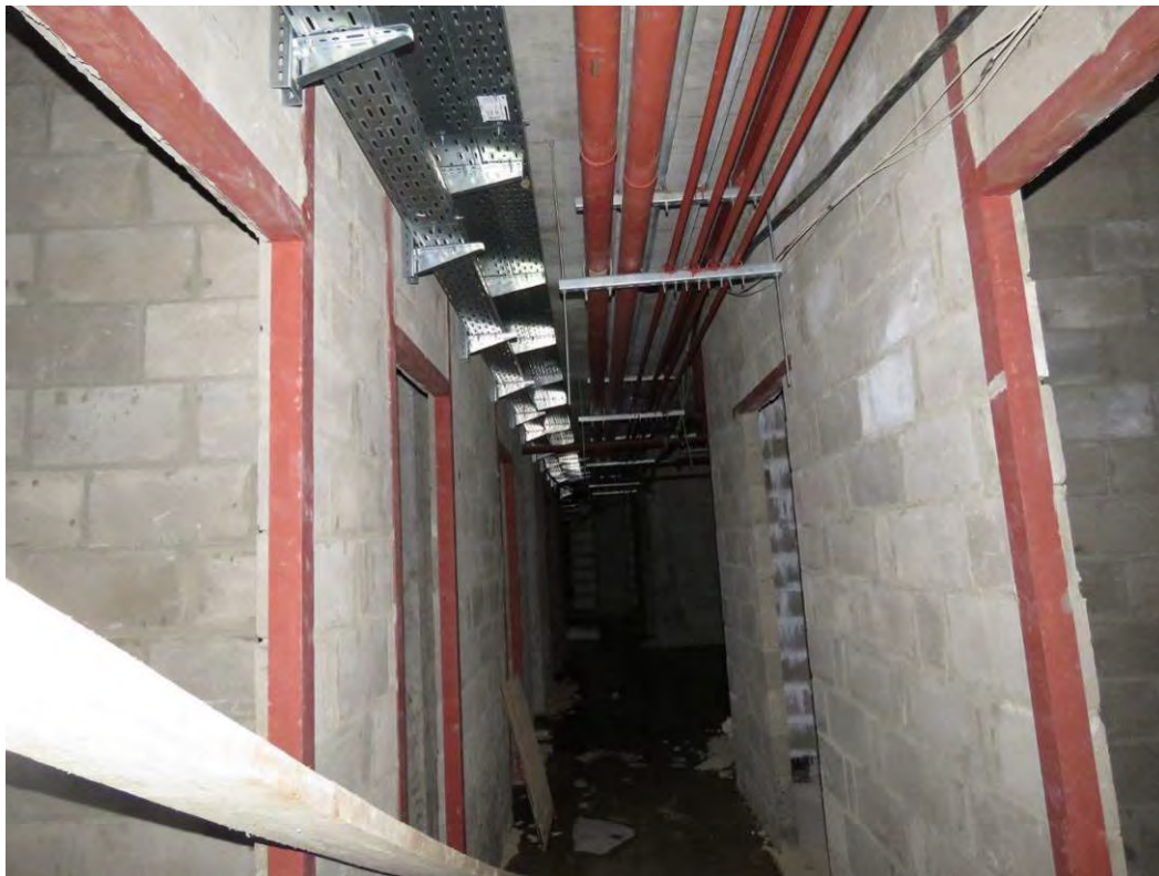
Рис.3.7.1.1. Общий вид магистральных трубопроводов системы теплоснабжения
