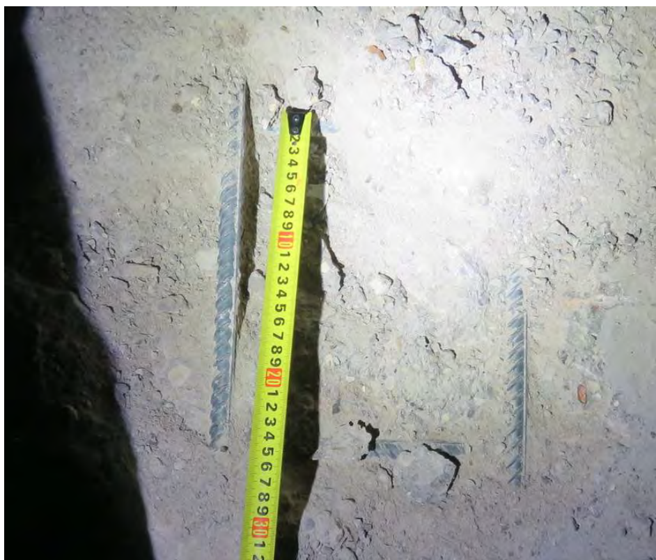
Рис. 3.1.8. Замер шага вдоль буквенных осей верхней зоны армирования наращённого слоя фундаментной плиты на участке вскрытия в секции 4 между осями Г/2 – А/2, 27/2-28/2
