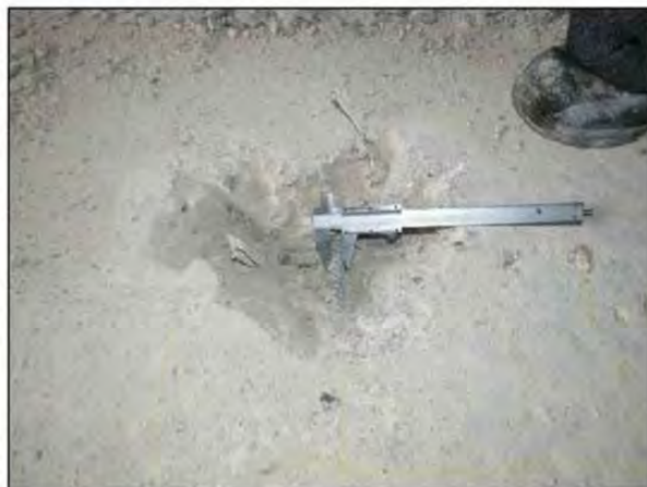
ФОТО 28. Уточнение диаметра рабочей арматуры монолитной железобетонной плиты пола седьмого этажа жилого дома между осями 16/2-17/2 - Б/2-В/2.
