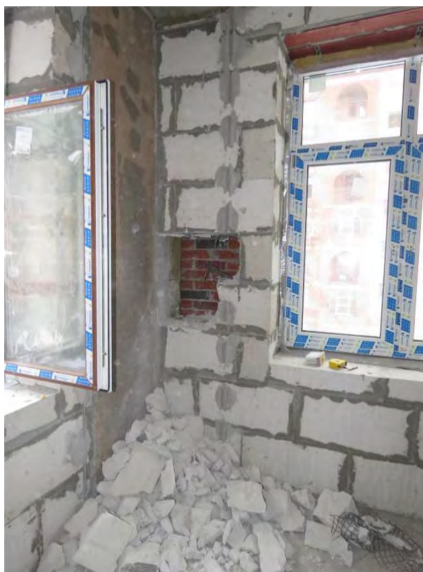
Рис. 3.4.12. Общий вид вскрытия ограждающей конструкции наружных стен примыкающих к пилону в уровне 3-го этажа на пересечении осей Т/2, 29/2
