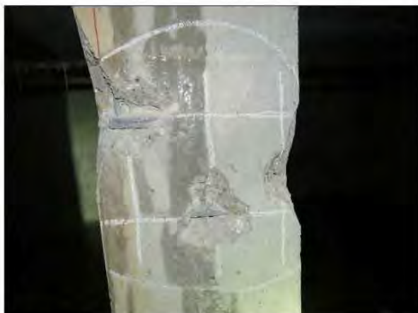
ФОТО 15. Общий вид вскрытия монолитной железобетонной колонны подвала жилого дома между осями Б/2-В/2 / 10/2-11/2.
